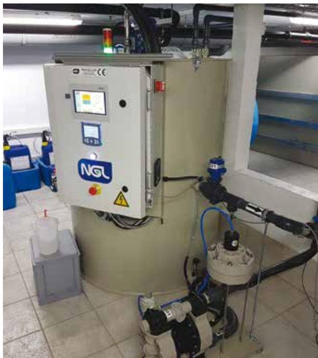
Station de traitement des eaux polluées (STEP) conçue par NGL et utilisant le procédé physico-chimique automatique et sûr.
