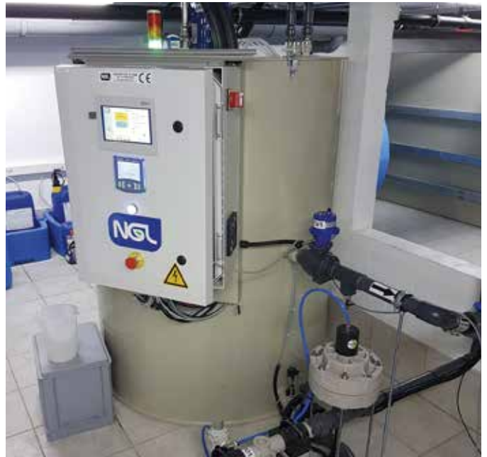
Station de traitement des eaux polluées (STEP) conçue par NGL et utilisant le procédé physico-chimique automatique et sûr.
